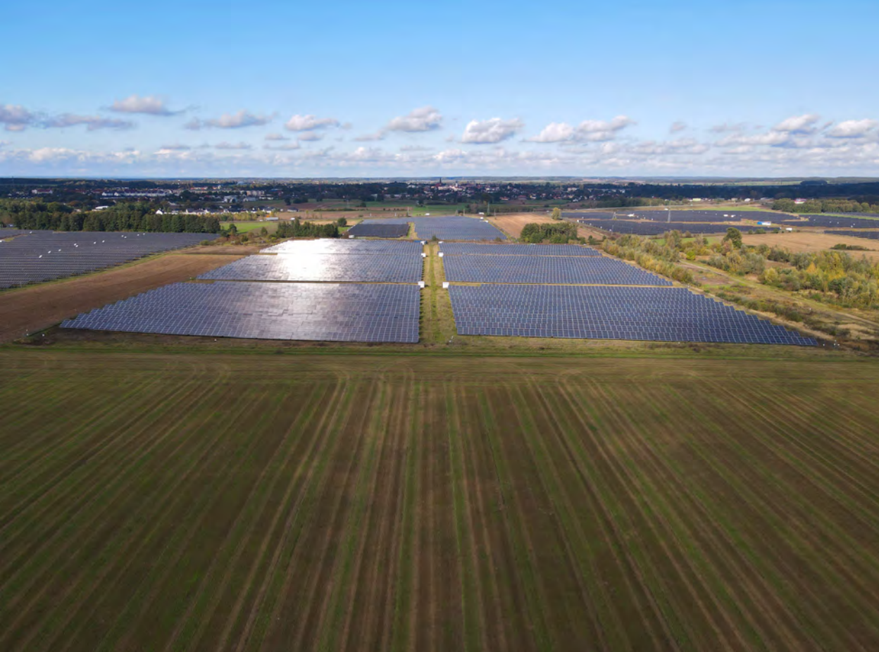
Fot. 31. Widok na Zespół Farm Fotowoltaicznych Sulechów w kierunku północnym (fot O. Ciebiera)
